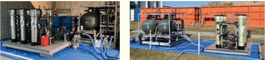
浄化装置設置状況
