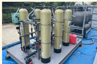
浄化装置設置
