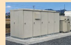
岐阜県各務原高圧蓄電所
