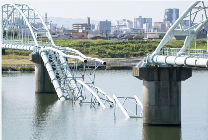
和歌山市六十谷水管橋落橋 約6万戸で断水
